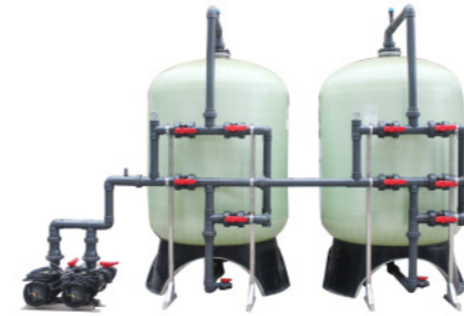
Hệ thống xử lý nước đầu nguồn
